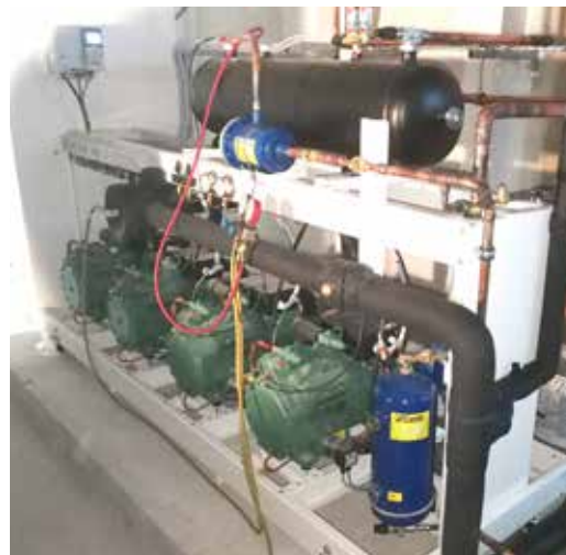
Fig. 1.a - Centrale frigorifera MB Frigo equipaggiata con nuovo controllo \mu Rack CAREL
