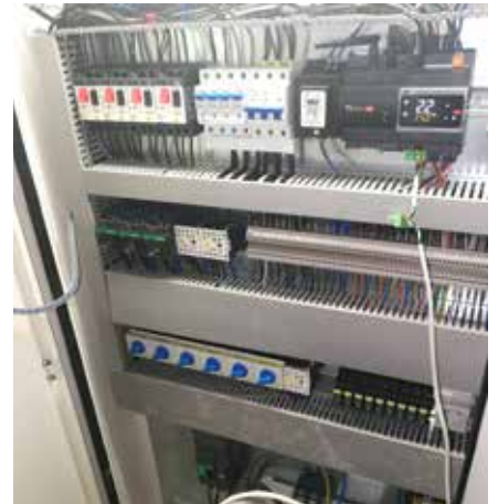
Fig. 1.b - Controllo \mu Rack posizionato all'interno del quadro elettrico della centrale frigorifera
