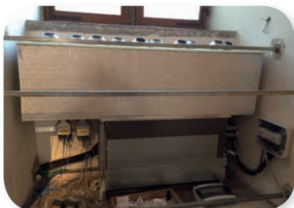
Dettaglio installazione tipo su sala museale di: sistemi di umidificazione ultrasuoni, deumidificatore ed elettronica di gestione e regolazione su impianto di condizionamento.
