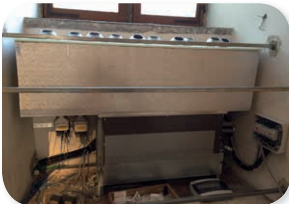
Detailansicht einer typischen Installation im Museumssaal: Ultraschallvernebler, Entfeuchter und Steuerungs- und Regelelektronik der Klimaanlage
